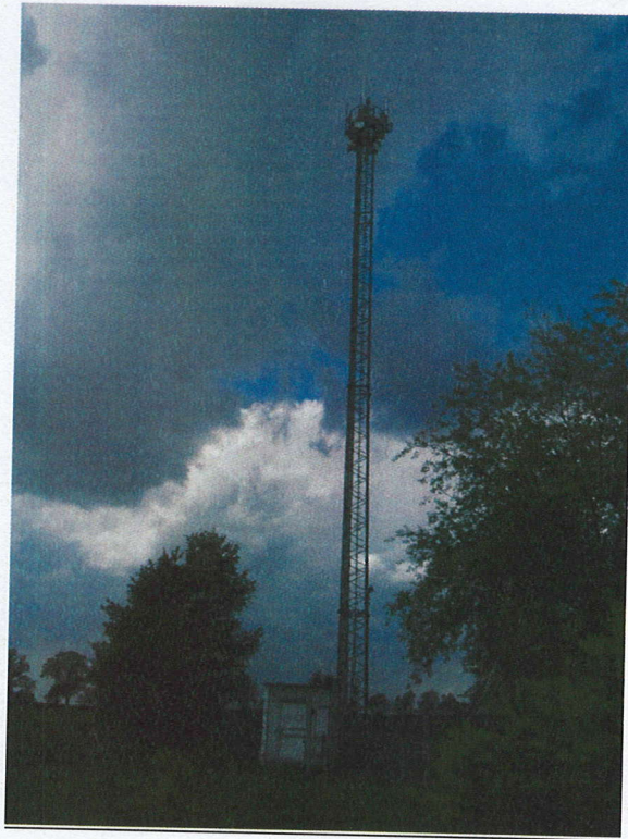
Zał. nr 1: Widok ogólny instalacji radiokomunikacyjnej.
