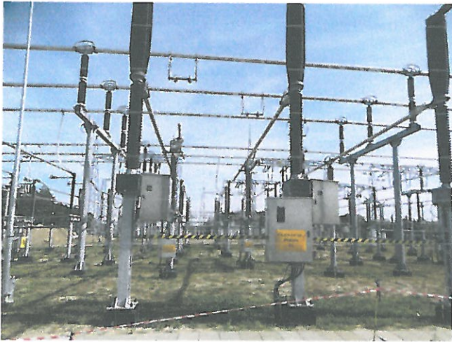
Pole 220 kV – Łącznik szyn
