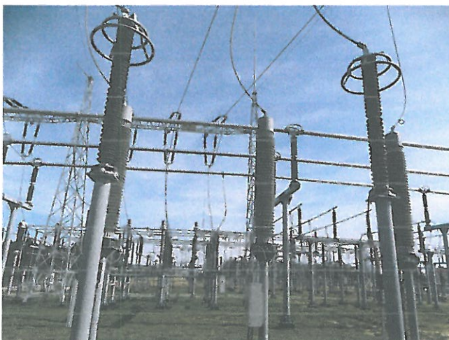
Pole 220 kV – linia Mikułowa
