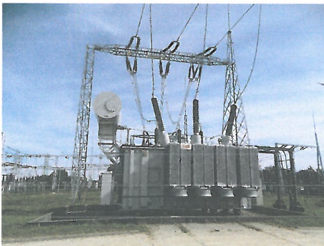
Autotransformator AT1 strona 220 kV
