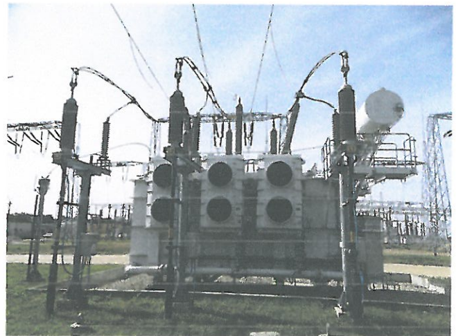
Autotransformator AT3 strona 110 kV
