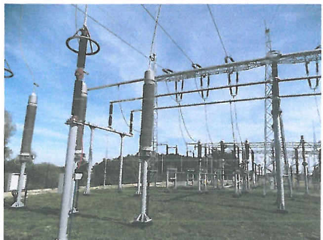
Pole 220 kV – linia Gorzów
