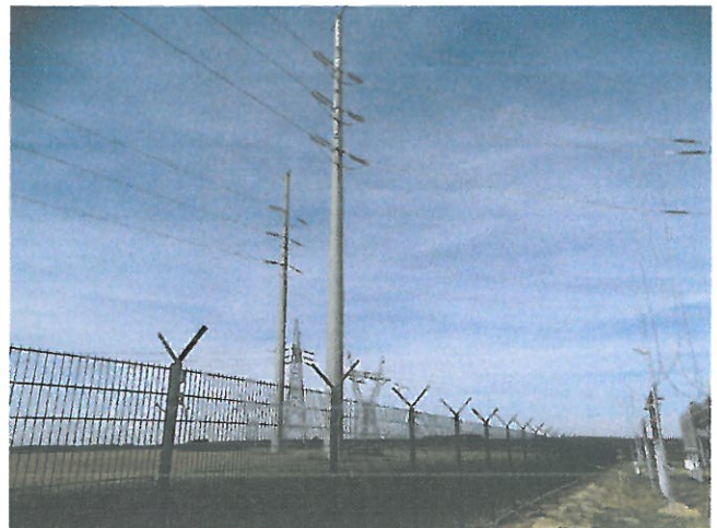
Wejście linii 220 kV do stacji Leśniów
