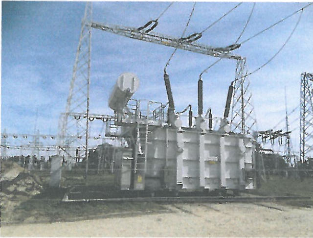
Autotransformator AT3 strona 220 kV
