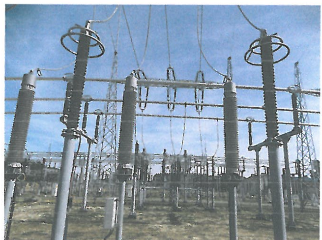
Pole 220 kV – linia Żukowice
