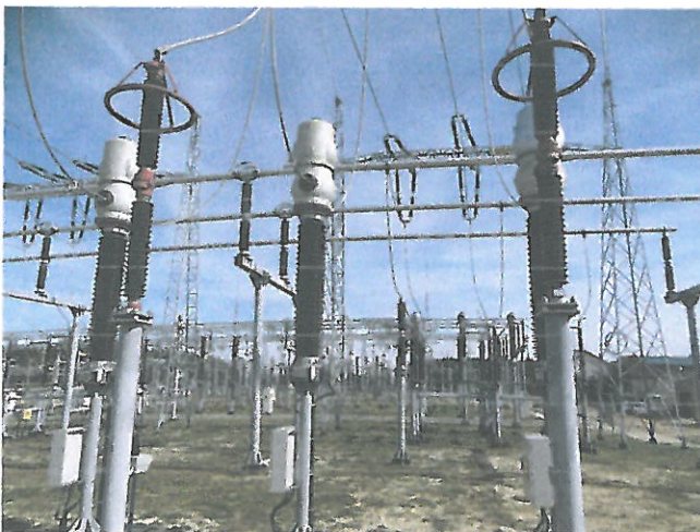
Pole 220 kV – linia Zielona Góra
