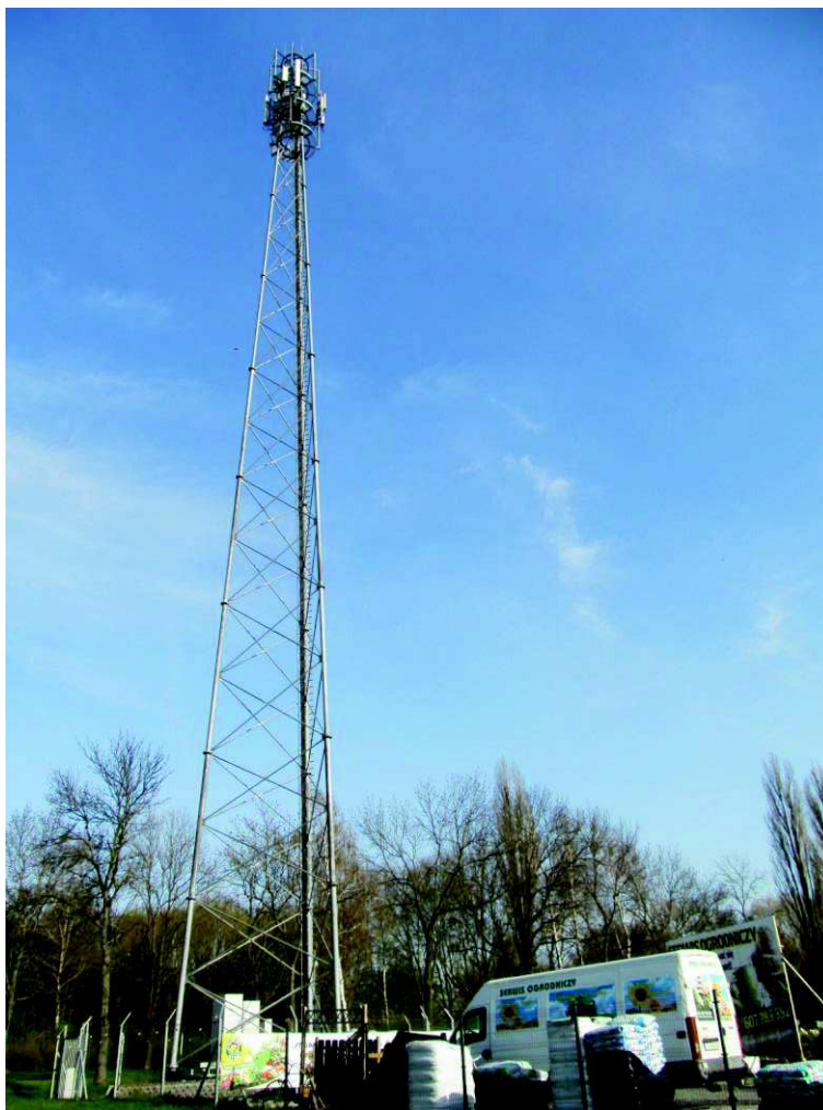
Zał. nr 1: Widok ogólny instalacji radiokomunikacyjnej.
